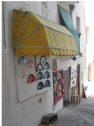
Fachada en mal estado y soportes expositivos
