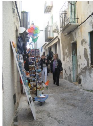
Fachada en mal estado y soportes expositivos
